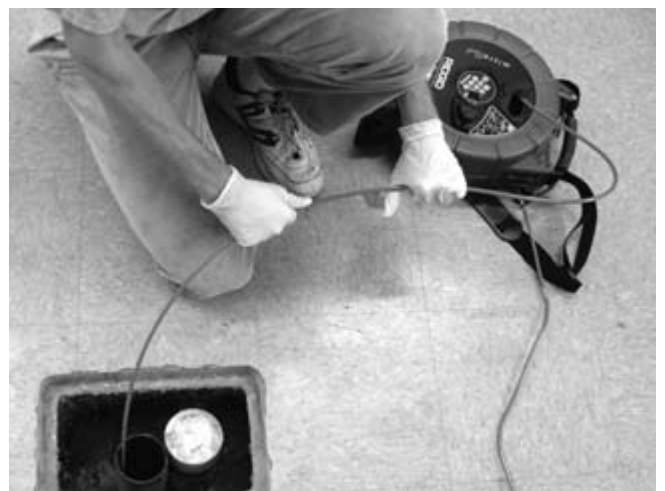
Abbildung 29 – Wenn das Kabel beim Zurückschieben in die Trommel Schlaufen bilden kann, kann es knicken
