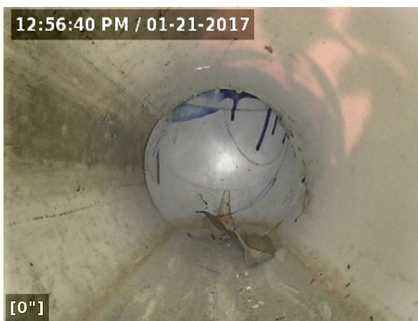
Con guía de tubería
