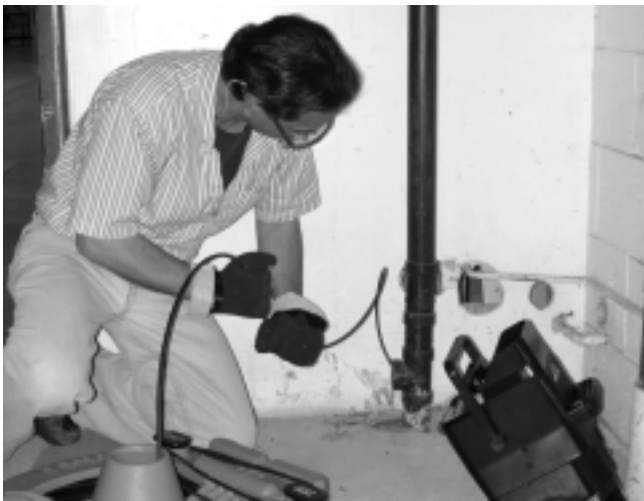
Figura 14 – Posición incorrecta de las manos sobre el cable de avance
