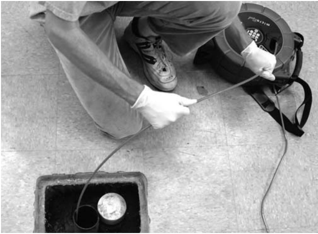
Figure 28 – Manière appropriée de rembobiner le câble d'avancement dans le tambour
