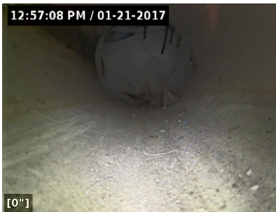
Sin guía de la tubería
